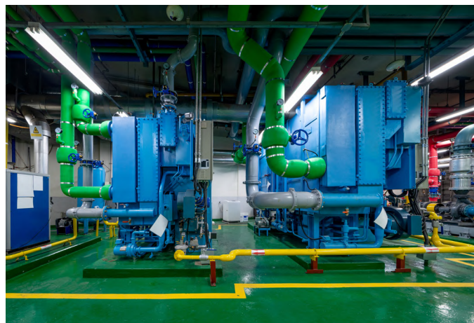
Figura 16 – Aspeto de uma instalação de refrigeração por absorção
